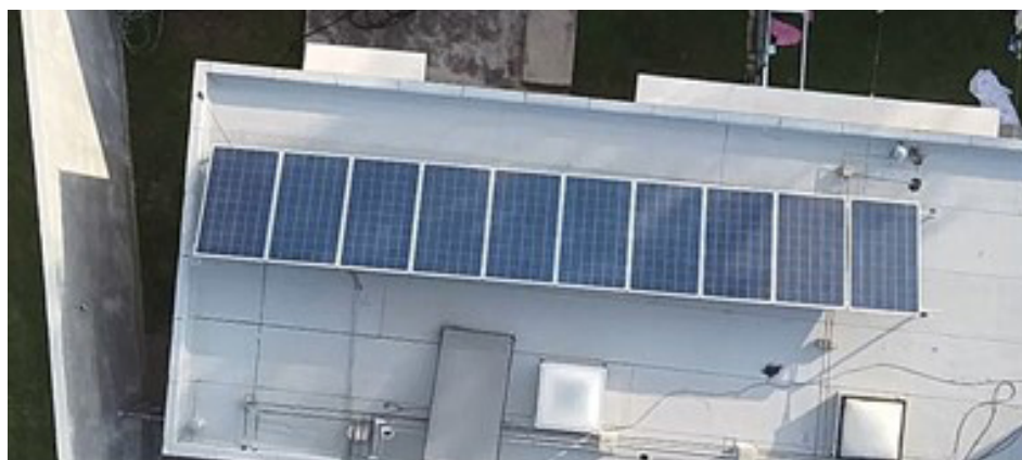
Figura 20.1. Paneles fotovoltaicos instalados en una casa habitación.
