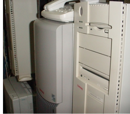
Fotografía 11 Espacio entre servidores
