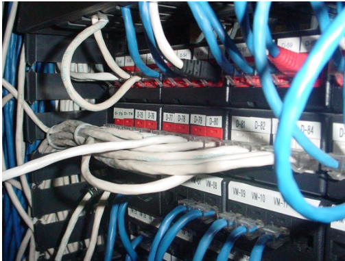
Fotografía 10 Distribución de cableado de red
