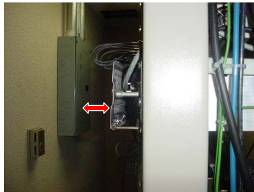
Fotografía 9 Espacio entre rack y centro de carga
