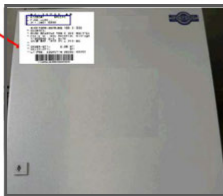
Figura 4.2.2 Caja de control identificada con una etiqueta.
