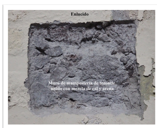
Figura 36. Detalle de la cala en la parte alta del muro de la Iglesia de Nuestra Señora de Loreto en la Ciudad de México. Fotografía: Salvador Ávila Gaytán, mayo 2021
