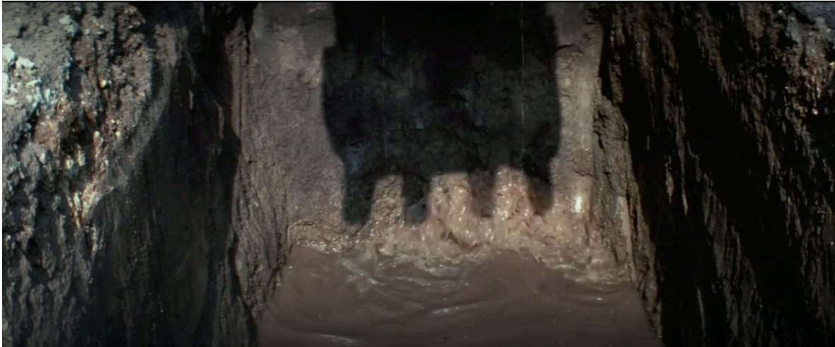
Figura 11. Agua saliendo a borbotones de la tubería rota.
